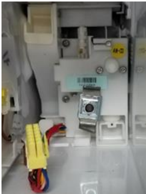
Auger Fan OK
